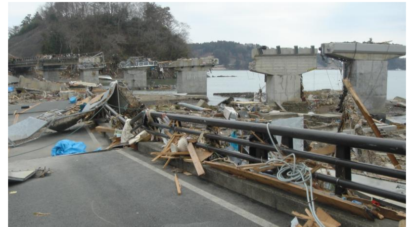
④国道45号:歌津大橋被災状況(3月15日)
