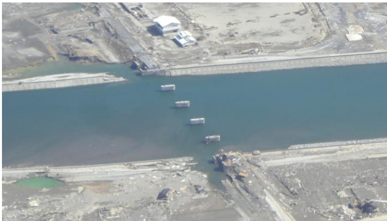
③国道45号:気仙大橋被災状況(3月19日)
