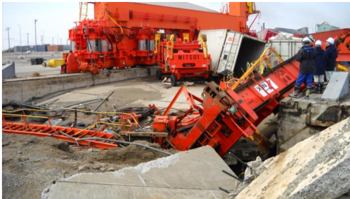
▲港湾被災状況調査(仙台塩釜港)
