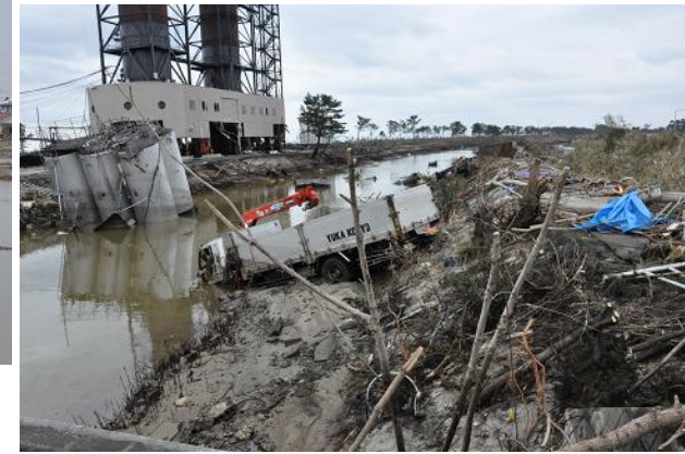
高砂南部排水機場 (宮城野区蒲生)
