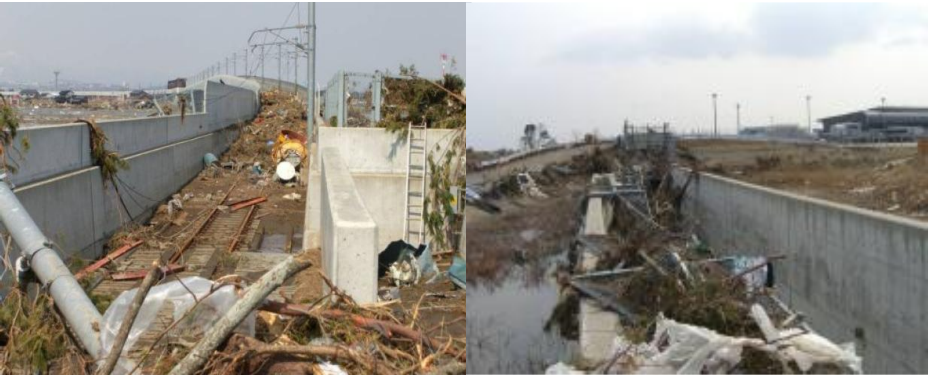
仙台空港線被災状況
